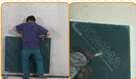
Poziționarea panoul pe perete și executarea gărilor de fixare, în număr de 5 pe fiecare panou (una în centru și patru pe colțuri).
