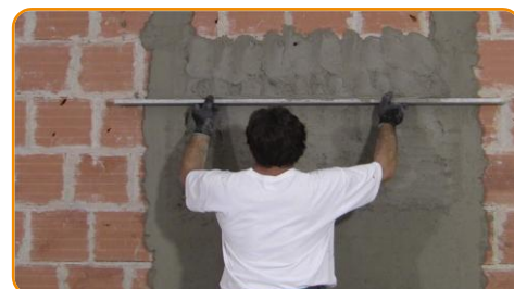
Aplicarea pe primul zid un strat de mortar grosier de cca. 1 cm grosime.
