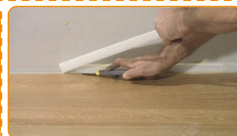
După montarea stratului circular, excesul de material Isogomma va fi înlăturat cu ajutorul unui cutter obișnuit.
